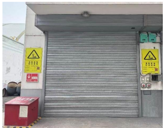
现有危废暂存间
