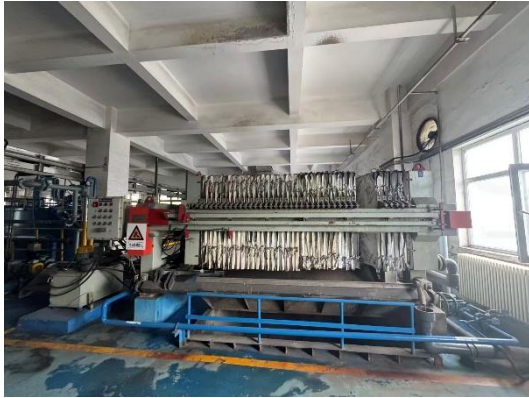
现有污泥压滤机
