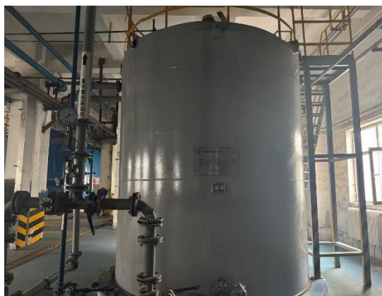
现有脱硫废水缓冲箱
