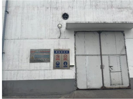
现有脱硫卸泥间
