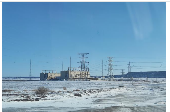
线路起点 220kV 火烧岩变电站
