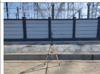
孚远 750kV 变电站厂界西侧 9#
