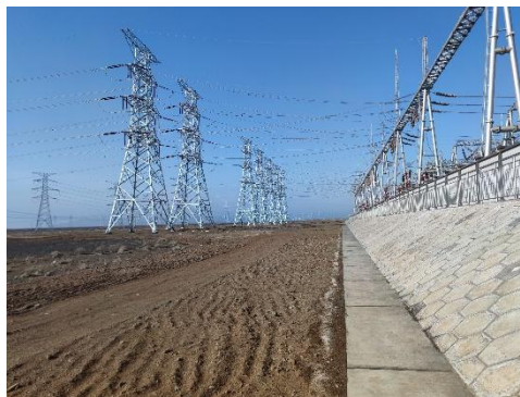
孚远 750kV 变电站南侧
