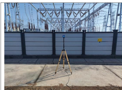
孚远 750kV 变电站厂界西侧 7#
