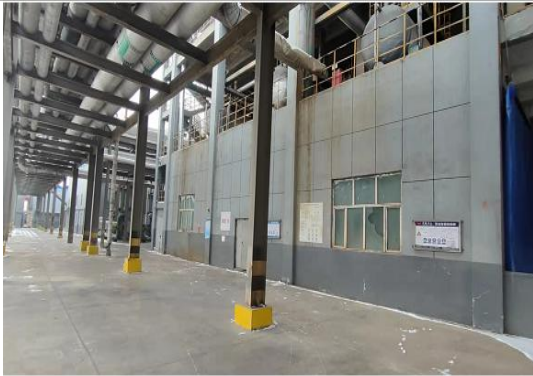
西侧精馏装置
