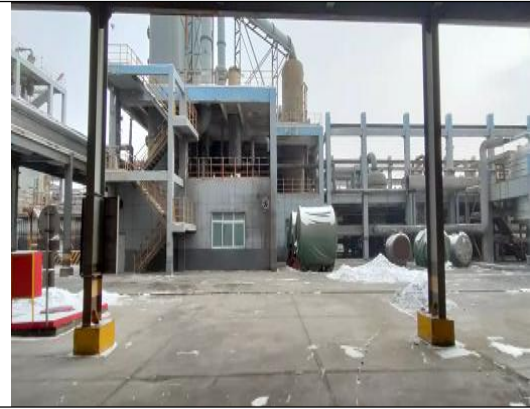
南侧净化装置
